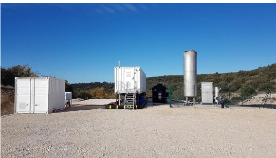
Unité de traitement des lixiviats
