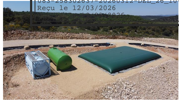
Cuves stockage et citerne incendie
