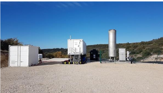
Unité de traitement des lixiviats
