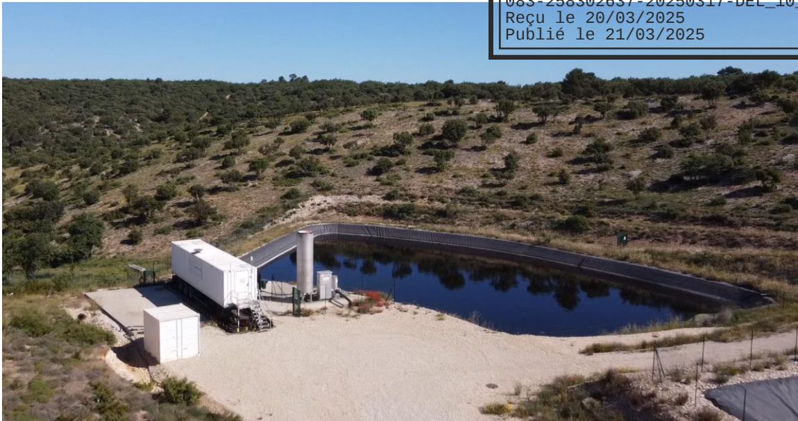
Bassin de stockage des lixiviats
