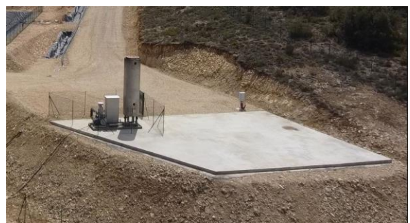
Torchère et dalle béton
