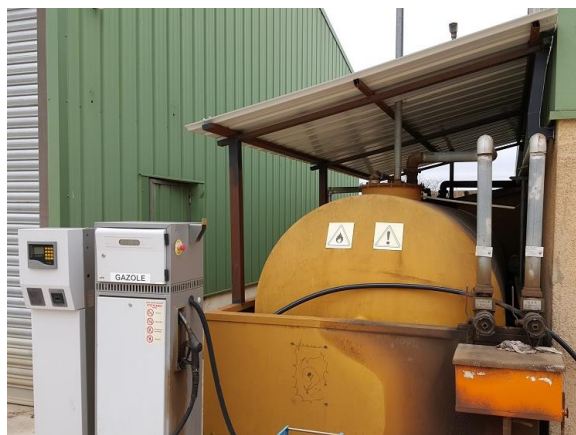
Cuve à carburant et volucompteur
